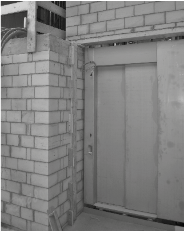
Der Lift im Schulhaus ist eingebaut und verbindet alle Ebenen vom Untergeschoss bis zum 2.Obergeschoss
